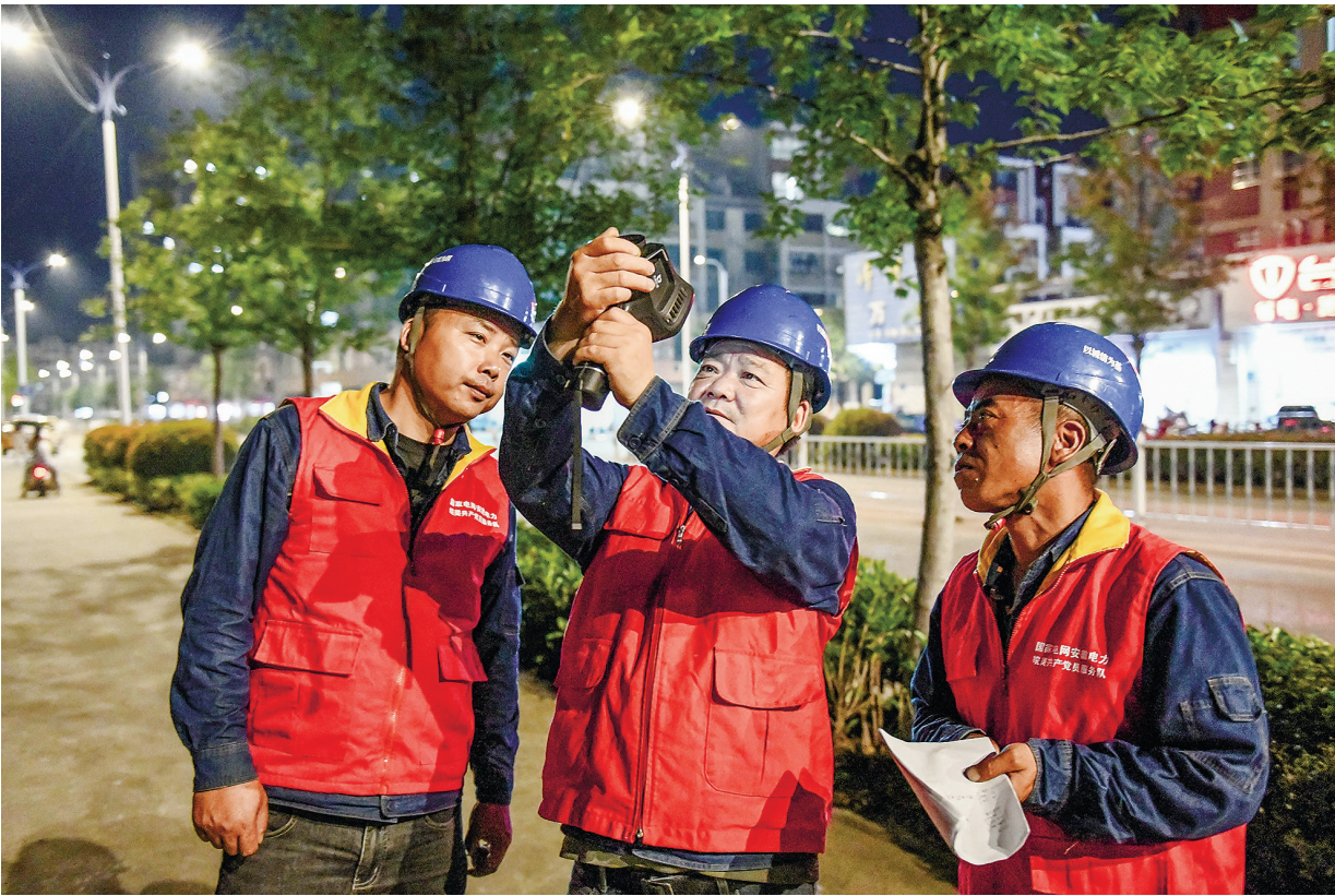
图为国网含山县供电公司工作人员检查考点附近线路。
