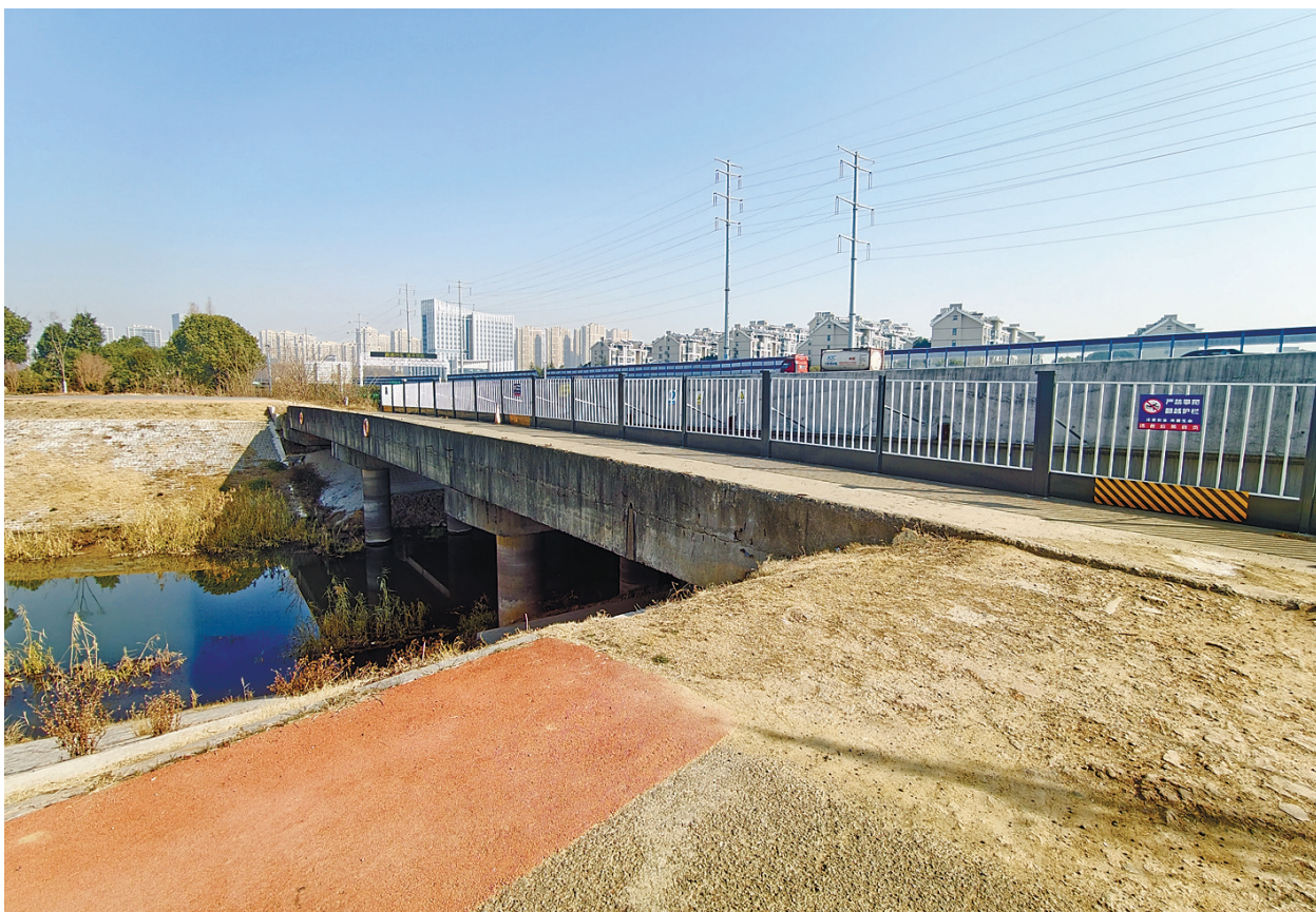
1月15日,该步道中断,沿线桥梁护栏高度仅60厘米,既不便市民出行,也存在安全隐患。记者 唐冰倩 摄
