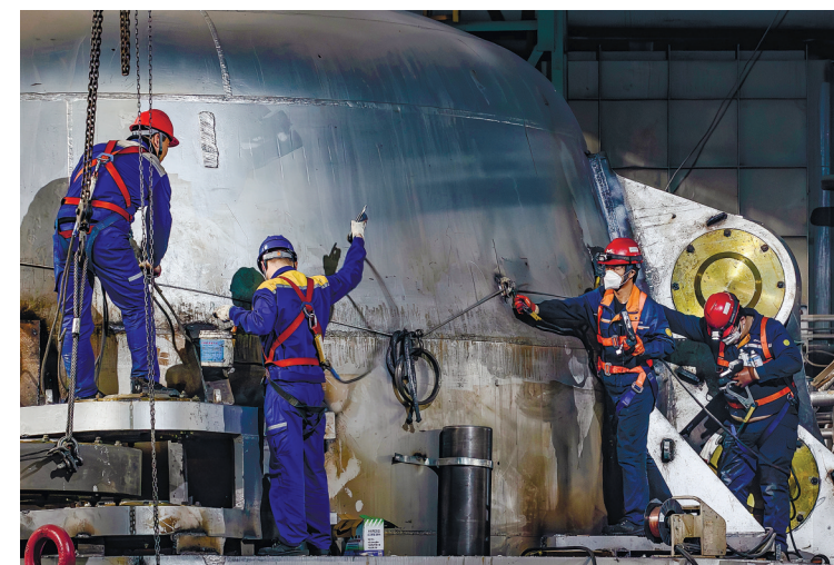
3月16日,马钢有限特钢事业部新特钢炼钢及精炼(二期)项目建设现场,施工人员正加紧进行转炉安装作业。项目建成后将进一步优化产业结构,增强企业核心竞争力。
