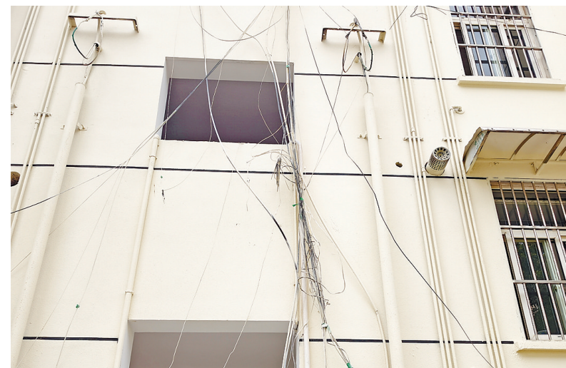
3月25日,进入小区11栋一单元,墙面上缆线像“蜘蛛网”一样。记者 唐冰倩 摄
