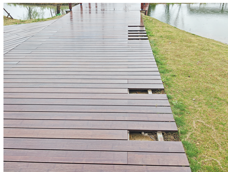
3月30日,阳湖公园西区栈道出现木板缺失。记者 张梦婷 摄
