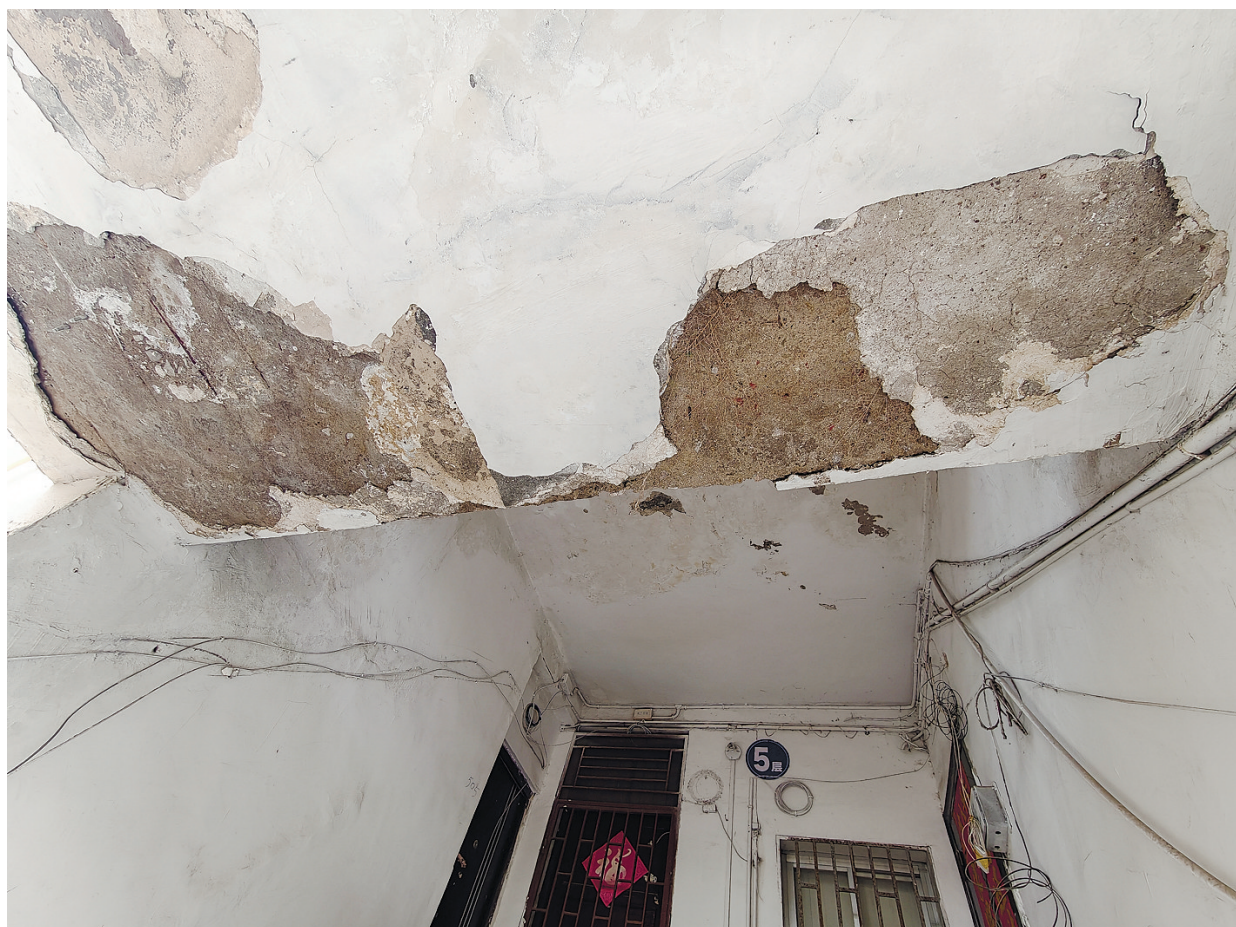
4月1日,汪女士居住的5楼楼道顶部墙皮大面积脱落。记者 张梦婷 摄
