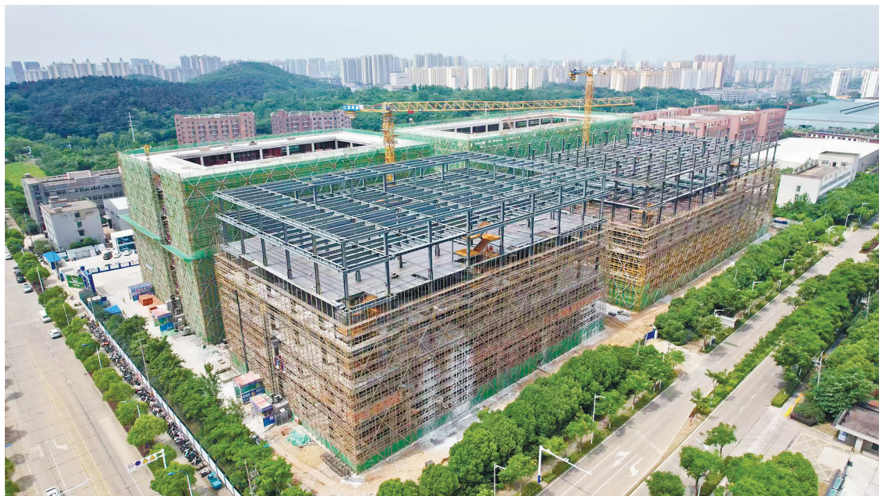
图为位于慈湖高新区陶甸路与赤口路交叉口西南角的生物医药加速产业园项目施工现场。
