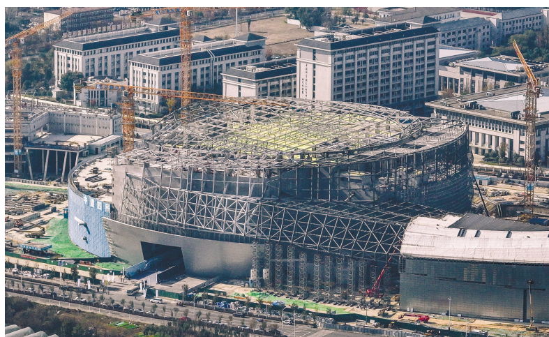
这是11月24日拍摄的紧凑型聚变实验装置(BEST)建设现场(无人机照片)。新华社记者 周牧 摄
